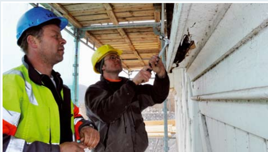
Byggeleder Reidar Haugo fra Castor Kompetanse og snekker Franck Favris fra entreprenøren Lars Andre Espesgaard AS besiktiger råteskader i tårnet.
